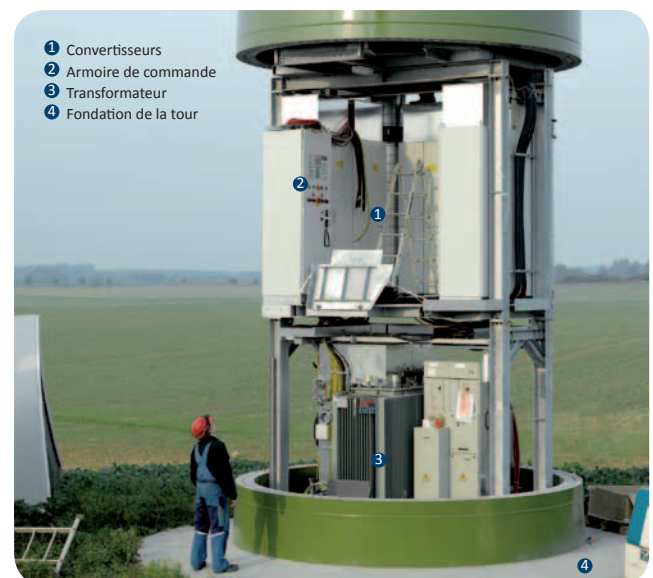
Composants électroniques dans le mât d'une éolienne
